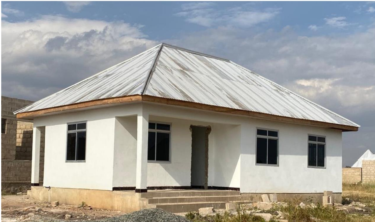
Ujenzi wa nyumba ya mtumishi katika Zahanati ya Mwatulole Kata ya Buhalahala ukiwa kwenye hatua za ukamilishwaji
