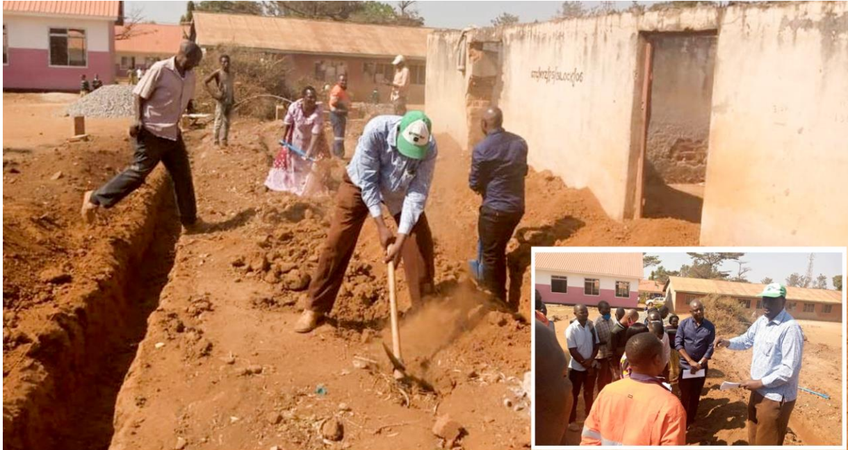
Mkuu wa Wilaya ya Geita Mhe. Wilson Shimo akishiriki shughuli ya uchimbaji msingi wa vyoo 13 vya wanafunzi Shule ya Msingi Nyanza, vyoo hivyo vinajengwa kwa Shilingi milioni 25 na Kampuni ya African Underground Mining Services Limited
